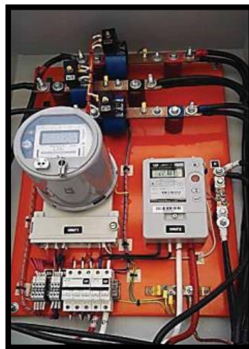
Fig. 23. Tablero de medición de Grandes Clientes. [22].
