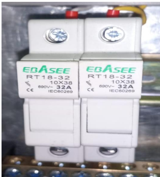
Foto 12. Fusibles de protección
