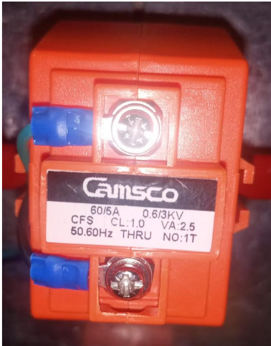
Foto 14. Transformador de Corriente (TC)
