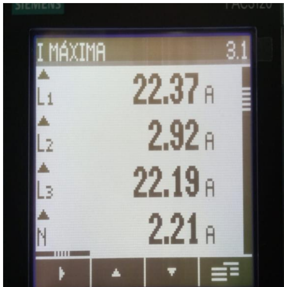
Foto 3. Medición de corriente por fase
