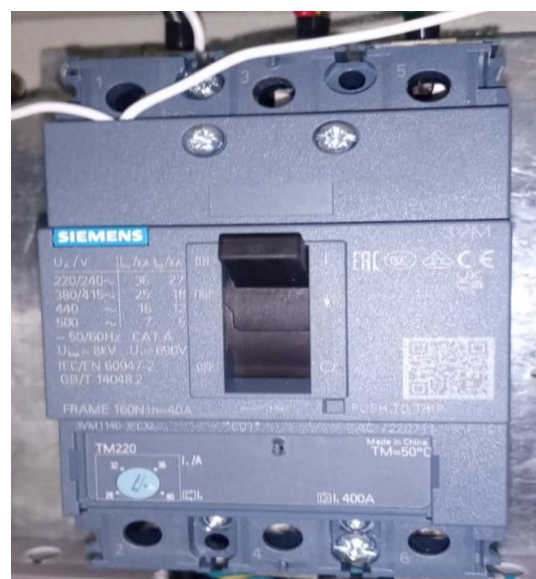
Foto 13. Breaker de protección
