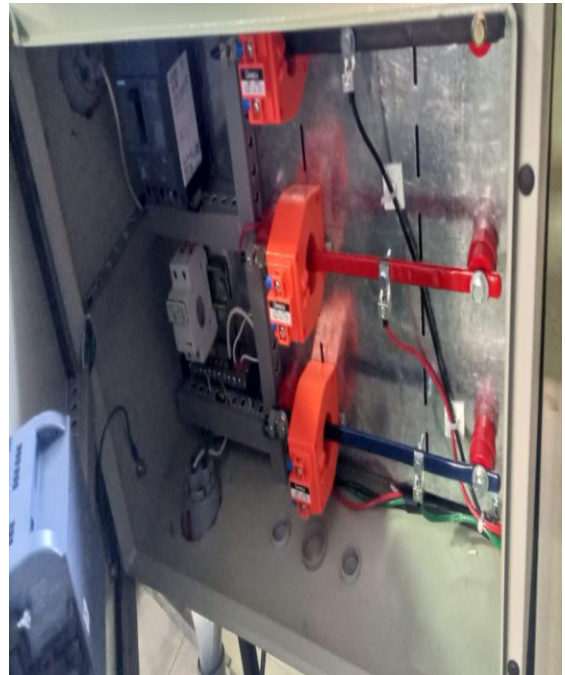
Foto 15. Gabinete del multimedidor
