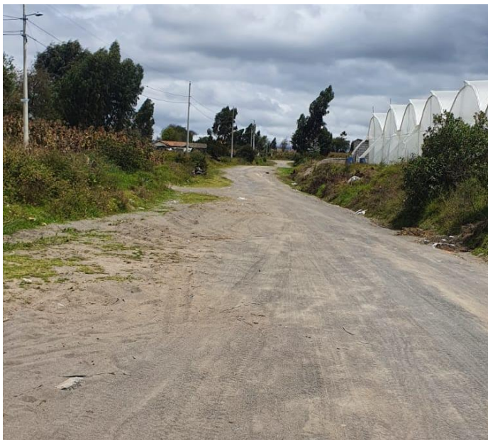
Estado de la vía de la zona alta
