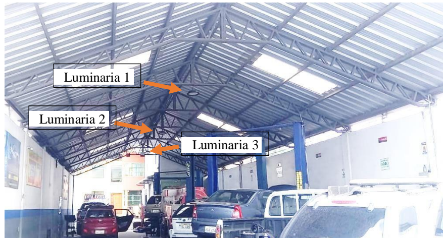
Figura 3.19 Luminarias dentro del área de mantenimiento
