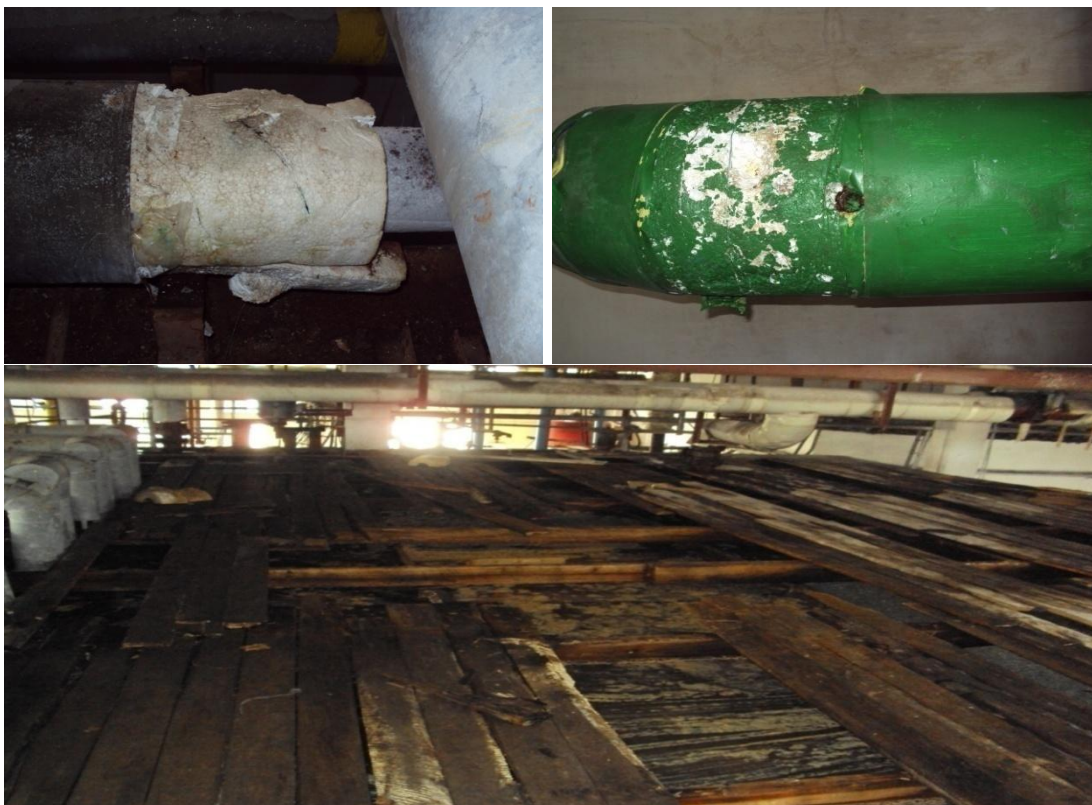
Anexo 4. Aislamientos térmicos deteriorados en las tuberías y techo del banco de agua helada del sistema de refrigeración en la línea de leche, respectivamente.
