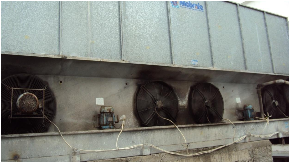
Anexo 3. Condensador evaporativo del sistema de refrigeración de la línea de leche de leche.
