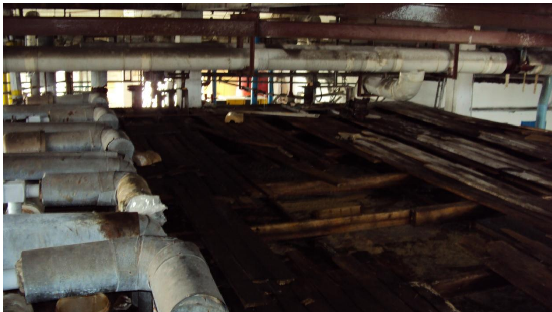
Anexo 1. Banco de agua helada del sistema de refrigeración de la línea de leche.
