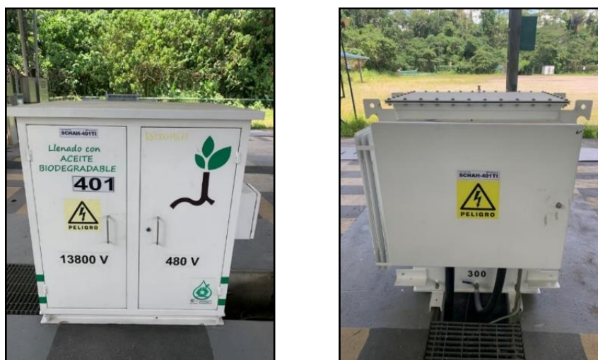
Figura 21. Transformador reductor y elevador de sistema BES
