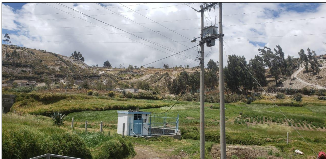
Figura 3.13. Casa de bombas
