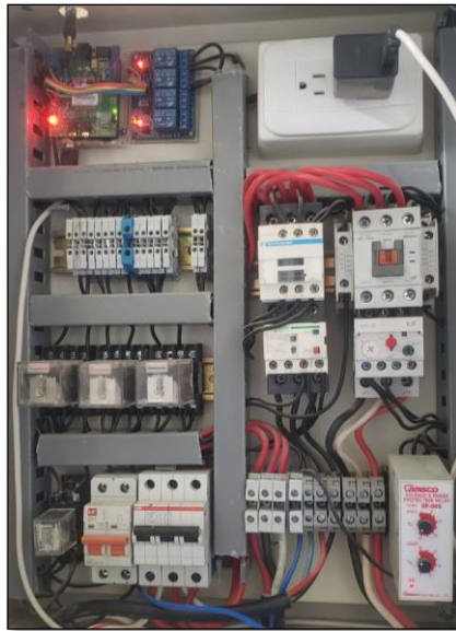
Figura 2.11. Conexión del tablero receptor de SMS
