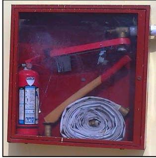
Foto 4: IMPLEMENTOS PARA EXTINCIÓN DE INCENDIOS
