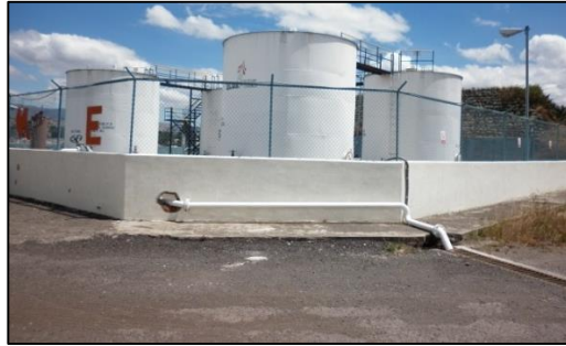
Foto 14: TANQUES DE COMBUSTIBLE
