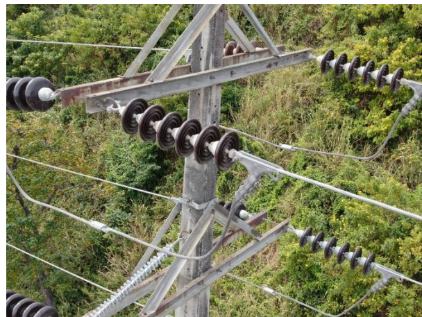
Figura 38: Conjunto de aisladores a evaluación
