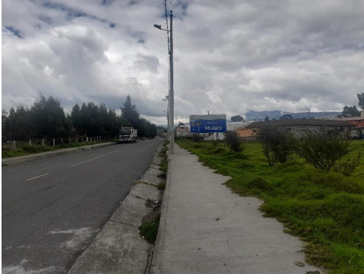
Figura 17. Estado de la vía de la Parroquia Mulaló
