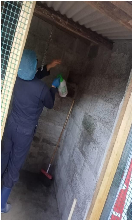
Nota: Desinfección con amonio cuaternario en las paredes, techo y piso.
