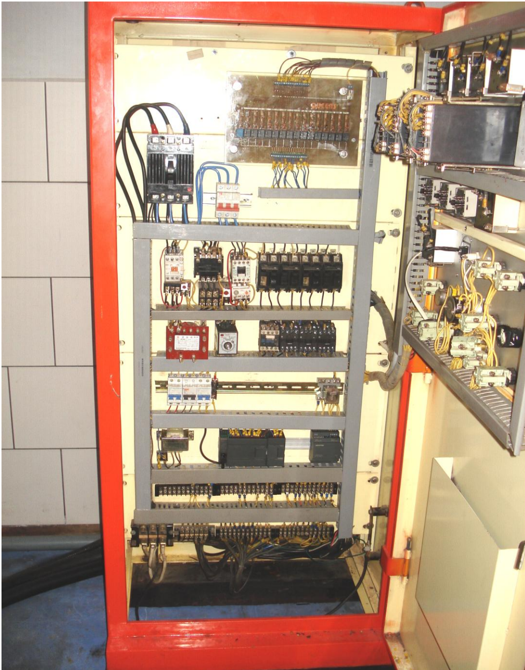
Figura 69: Elementos de automatización en el armario de control
