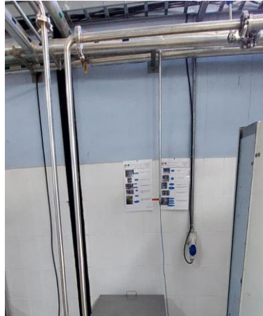
Figura 5: Tubos de transporte de fluidos
