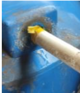
Presencia de fugas en el tanque
