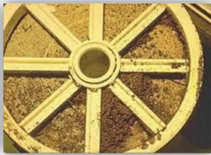
Ilustración 12. Membranas afectadas por incrustaciones (scaling)
