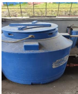
acumulación de polvo y otros contaminantes.
