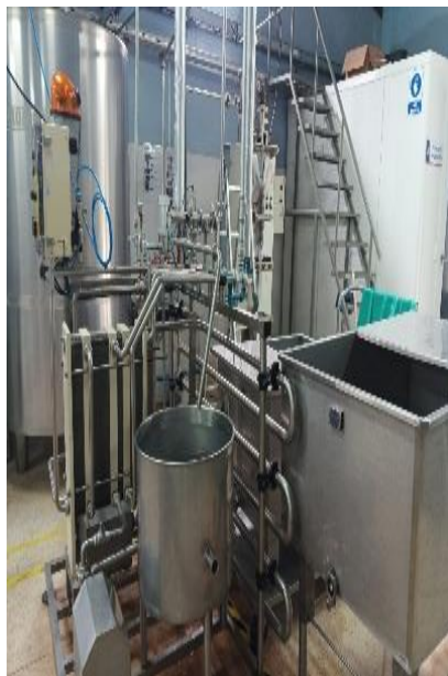
Ilustración 1. limpieza de pasteurizadora de placas.
