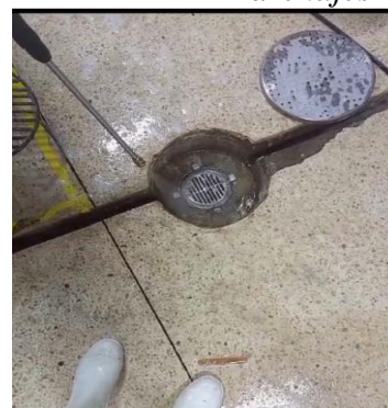
Ilustración 12. hallazgos de tierra en drenajes
