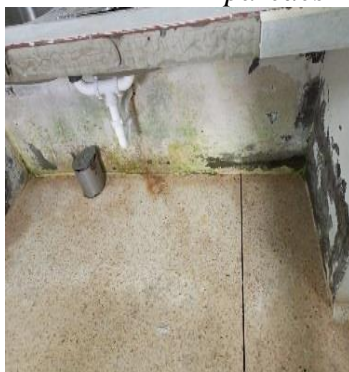
Ilustración 11. hallazgos de mohos en paredes
