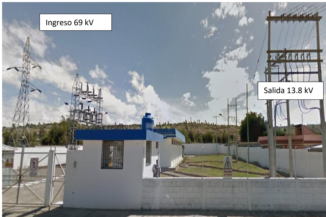
Figura 3.3 Subestación La Cocha
