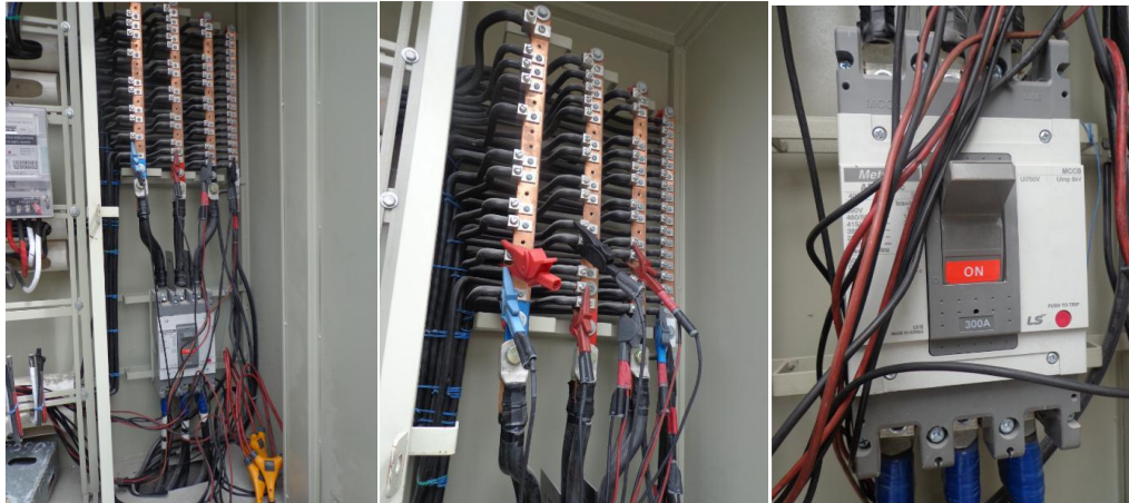
Figura 11 Instalación analizadores energía
