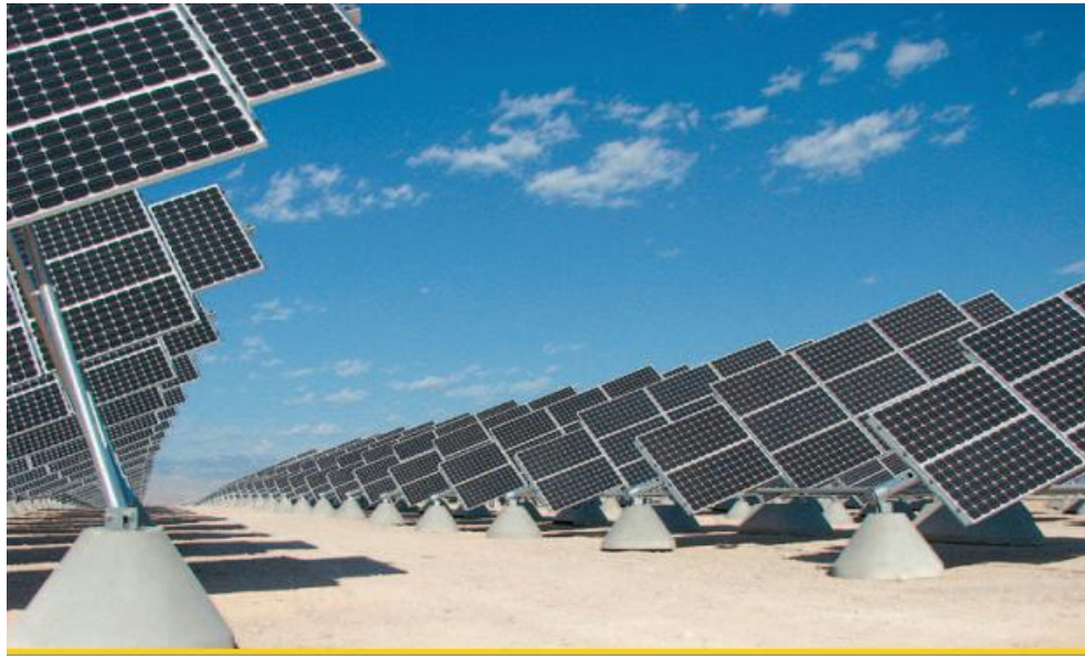
Fig. 1.3. Campo de Paneles Solares Fotovoltaicos auto dirigidos (EE.UU.).
