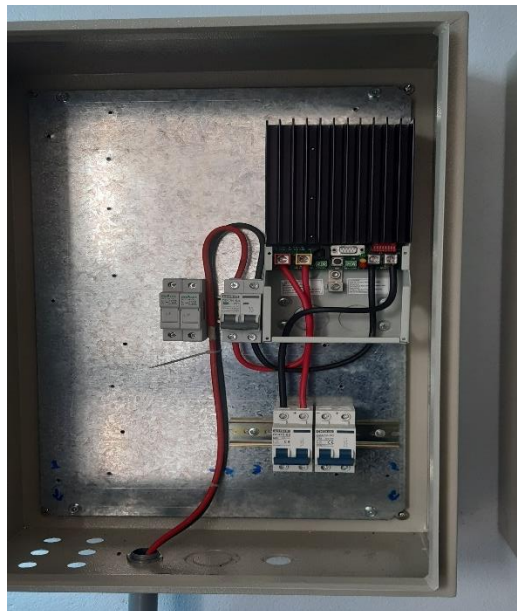
Figura 3.18: Implementación de protecciones salida del regulador de carga
