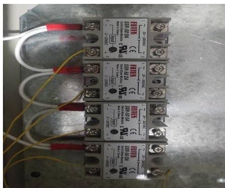
Figura N°15 Instalación y conexión de los relés de estado solido
