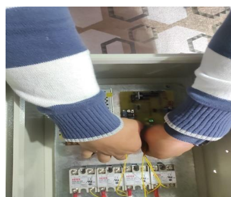
Figura N°18 Conexión fuente de alimentación
