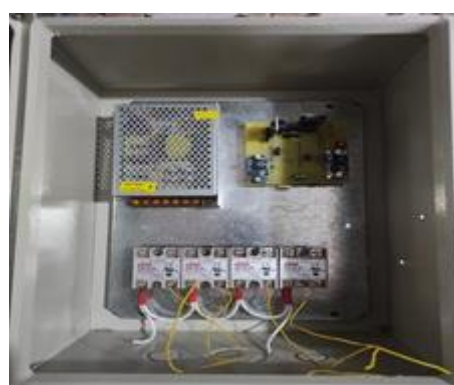
Figura N°20 Vista frontal de las conexiones
