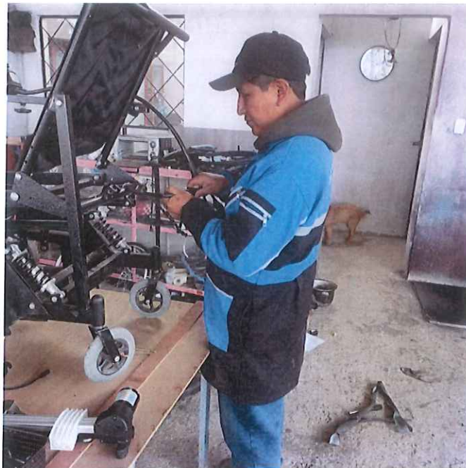
Figura IX. Instalación eléctrica de la silla.
