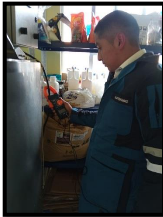
Figura 3.37: Revisión de conexiones
