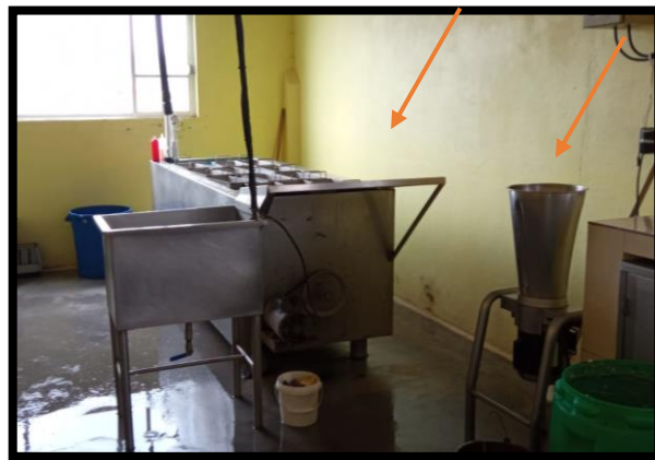
Figura 3.39: Piscina de congelación y licuadora industrial con riesgo de contacto eléctrico indirecto por posición inadecuada.
