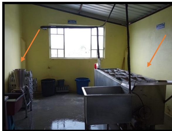
Figura 3.40: Piscina de congelación y licuadora industrial en posición adecuada sin riesgo de contacto eléctrico indirecto.
