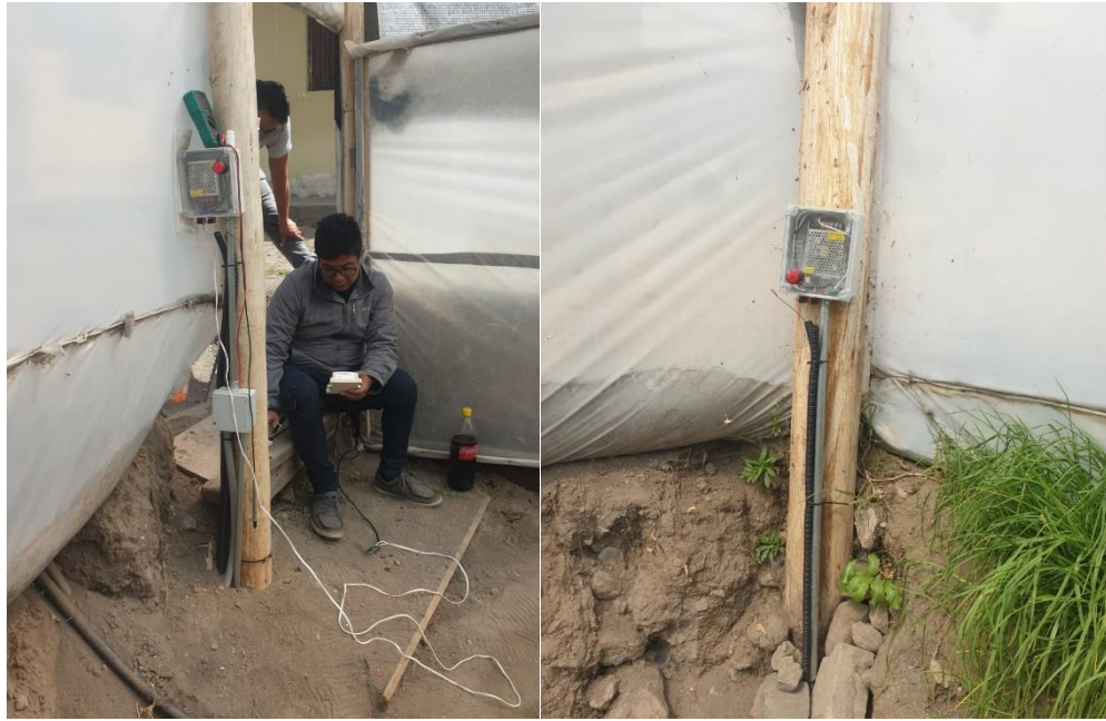
Figura D.2. Instalación de fuentes DC
