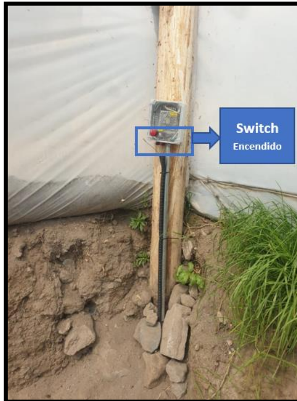
Figura 7. Encendido de fuentes DC.
