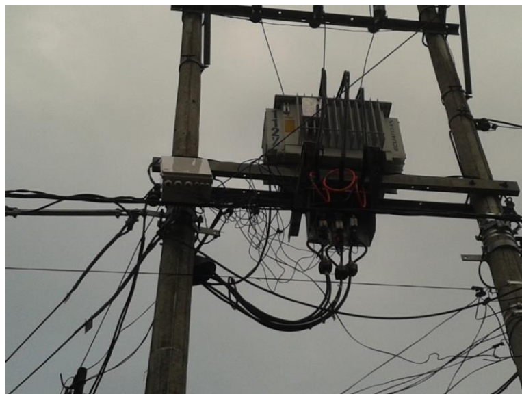
Ilustración 3.3 Ubicación del analizador en el transformador de CNEL
