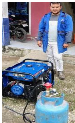
Imagen 26. Prueba de funcionamiento del sistema híbrido con Biogás
