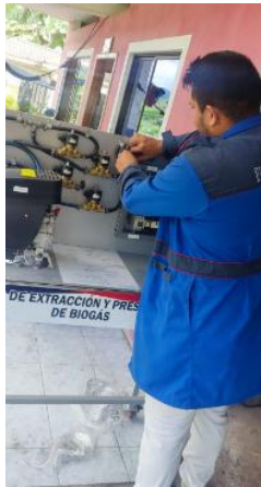
Figura 6. Mantenimiento del equipo de extracción y presurización de biogás
