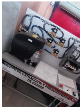
Imagen 21. Equipo de extracción y pasteurización de Biogás UTC
