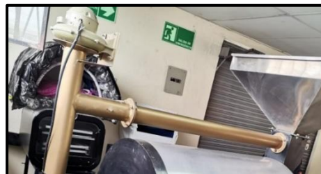
Figura 20. Ducto de extractor.
