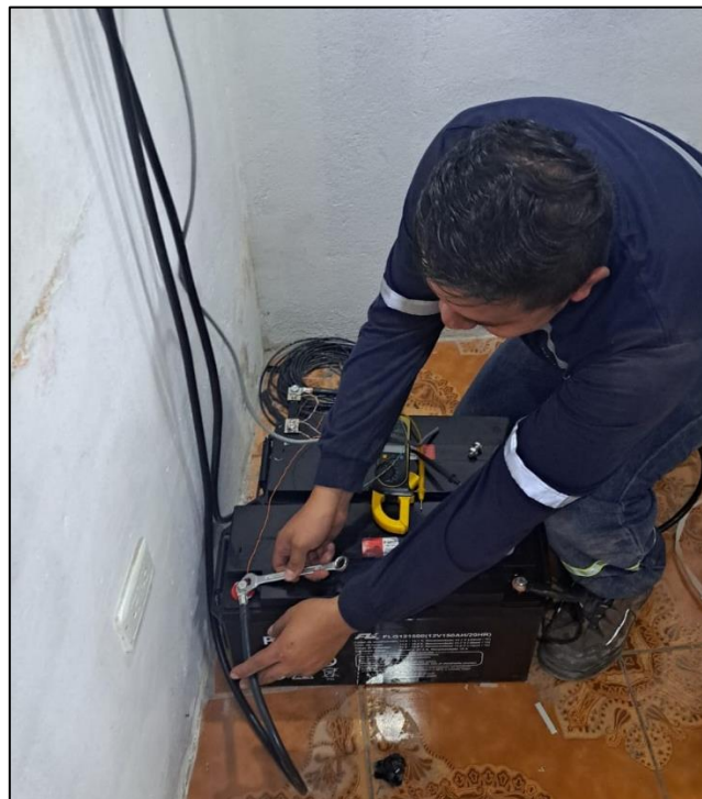
Figura 4.24 Conexión de las baterías del sistema
