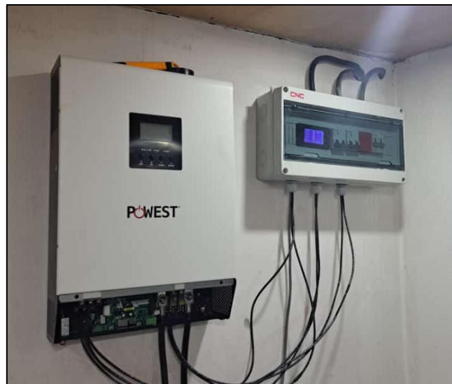
Figura 4.23 Conexión del inversor híbrido con el cuadro general
