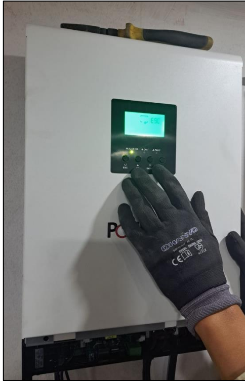
Figura 4.25 Encendido del inversor híbrido
