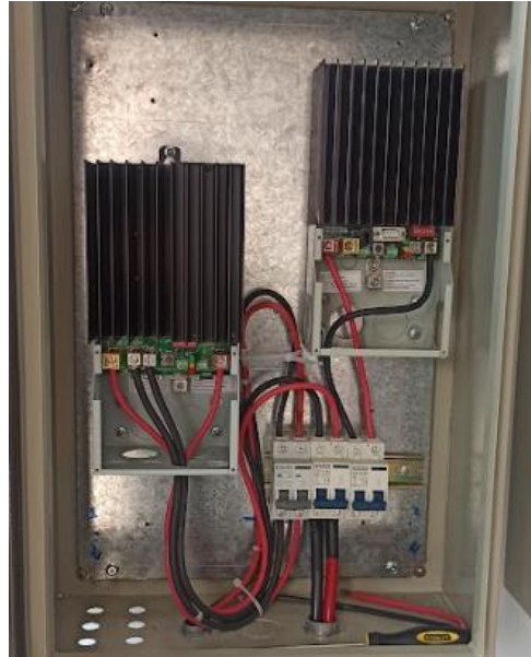
Figura I.4. Conexión física de los terminales del regulador.
