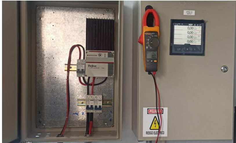
Figura I.1. Situación previa a la instalación del regulador MPPT.
