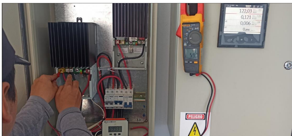
Figura I.3. Verificación de instalación de los terminales del regulador.
