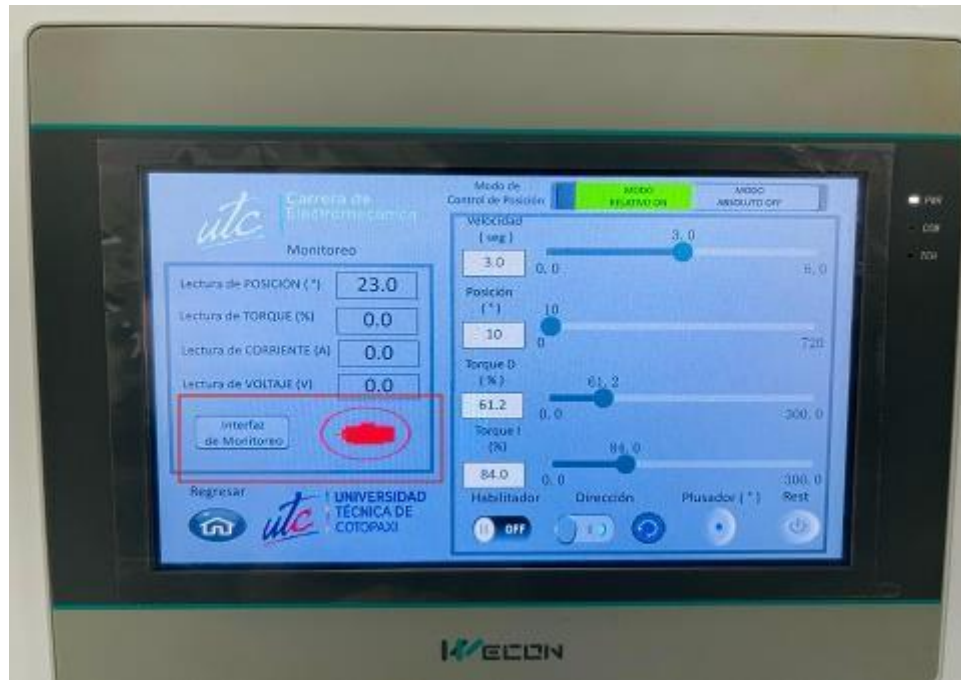
Figura 4.64. Fallo en el sistema de conexiones del servodriver.
