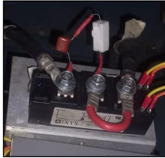
Figura 4.5 Red Snubber instalado en módulo tiristor Fuente: Grupo Investigador
