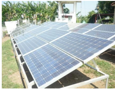
Paneles del sistema fotovoltaico.
