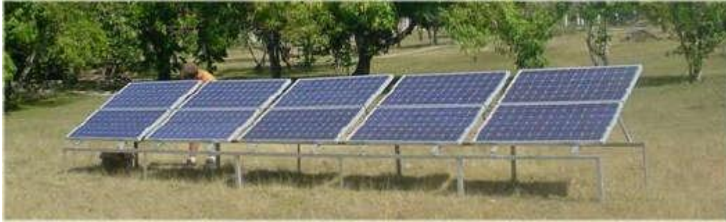
Paneles fotovoltaicos del sistema de abastecimiento de agua instalado en el Centro de Estudio Solar, de la Villa del Educador, en el municipio de Bartolomé Masó, Granma.
