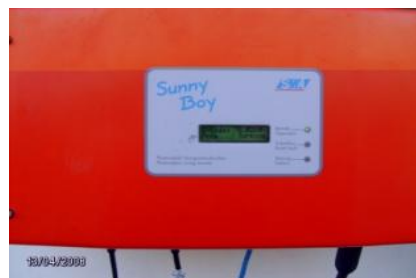
Fotografía del inversor instalado en el CES:
