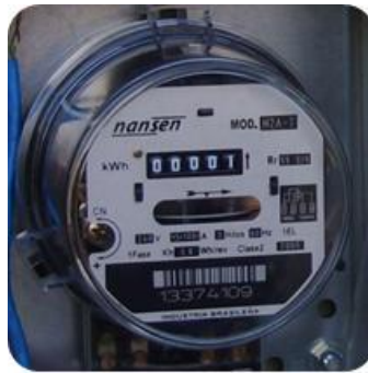
Contadores de energía instalados en el CES.
