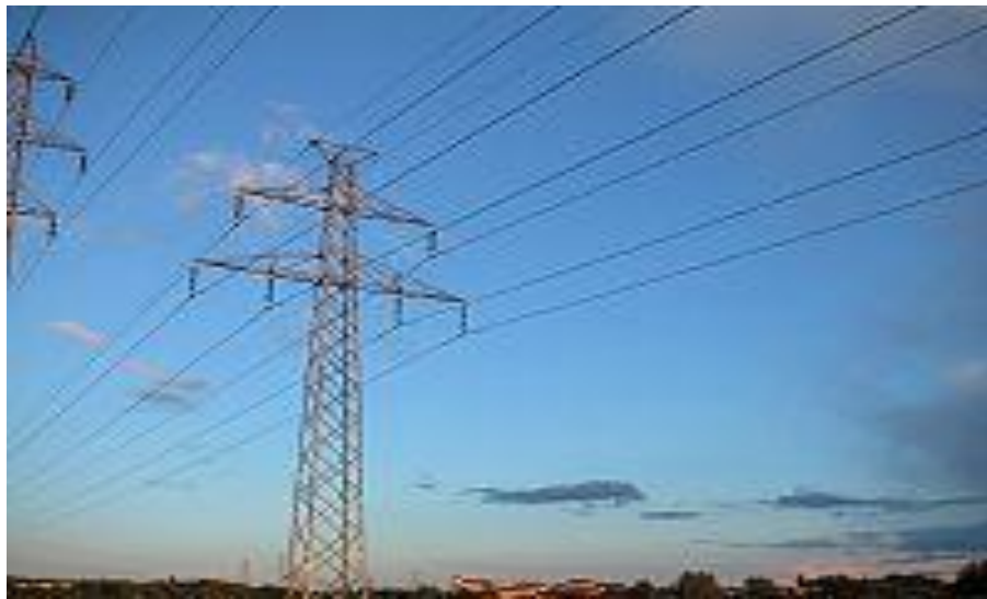
FIGURA N° 1.10: TORRE PARA EL TRANSPORTE DE ENERGÍA ELÉCTRICA
