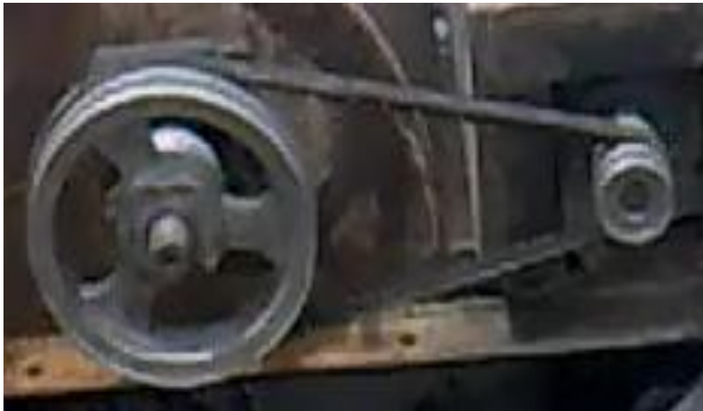
Bandas y poleas del Generador
