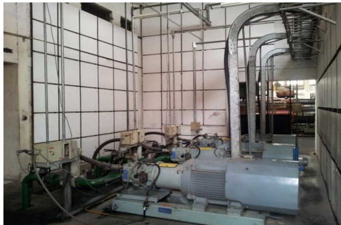
Figura#20 CUARTO DE BOMBAS Y GENERADOR
