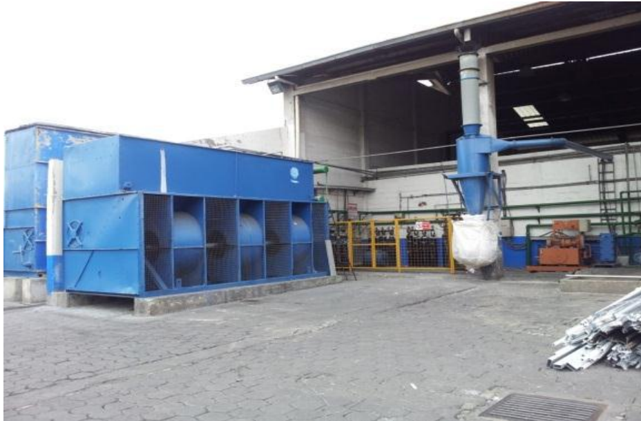
Figura#16 TORRE DE ENFRIAMIENTO
