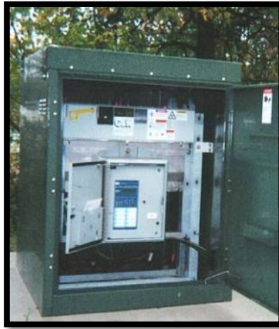
GRÁFICO N° 1-10; TRANSFORMADOR COMPACTO PADMOUNTED
