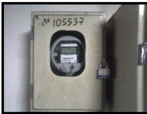
GRÁFICO N°3-8; MEDIDOR DE ESTADO SÓLIDO S4LANDIS+GYR
