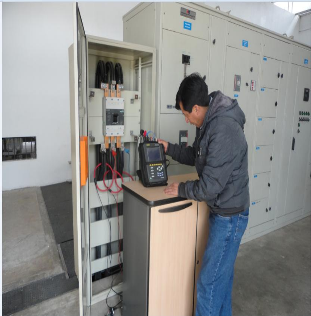
Figura 2.3. Conexión del analizador de energía eléctrica en el punto A.
