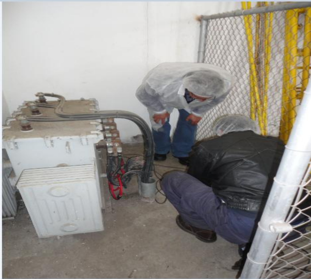
Figura 2.5. Conexión del analizador de energía eléctrica en el punto C.
