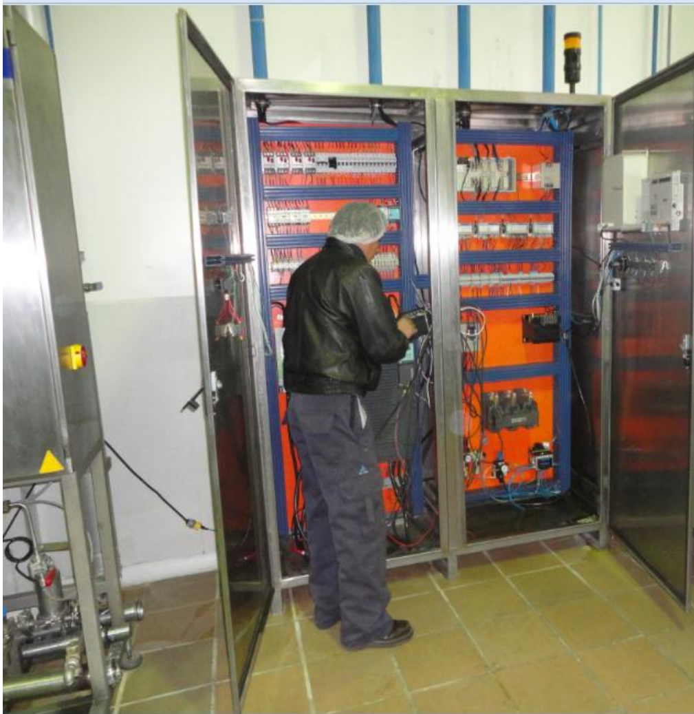
Figura 2.4. Conexión del analizador de energía eléctrica en el punto B.
