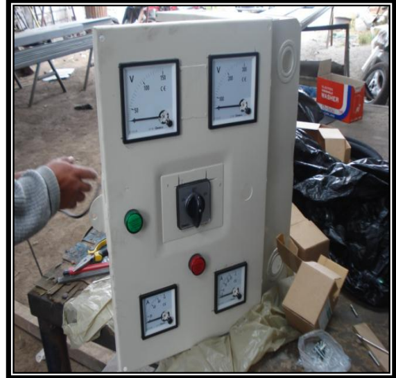
CAJA DE CONTROL CON VOLTIMETROS Y AMPERIMETROS
