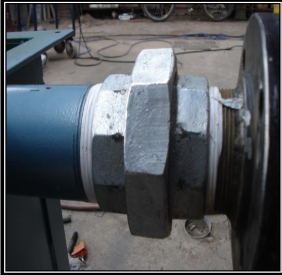
SISTEMA DE ACOPLA PARA EL INGRESO DE AGUA
