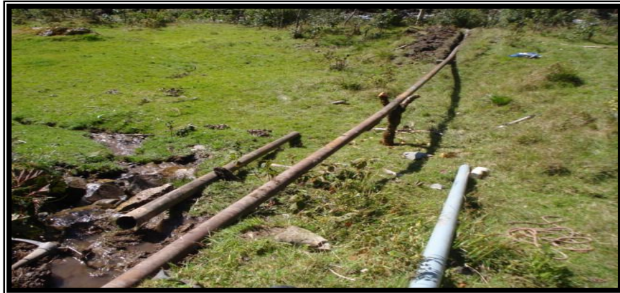
Fig. No. 3.22 Tubería de presión
