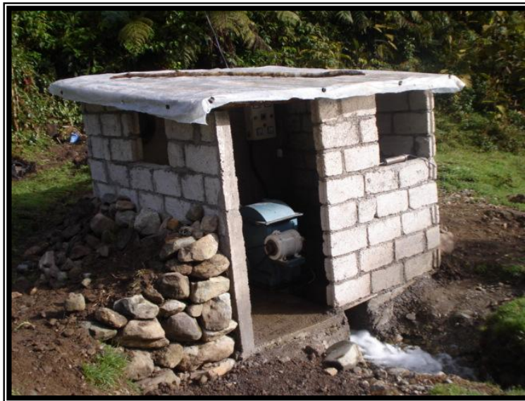
Fig. No. 3.23 Casa de máquinas
