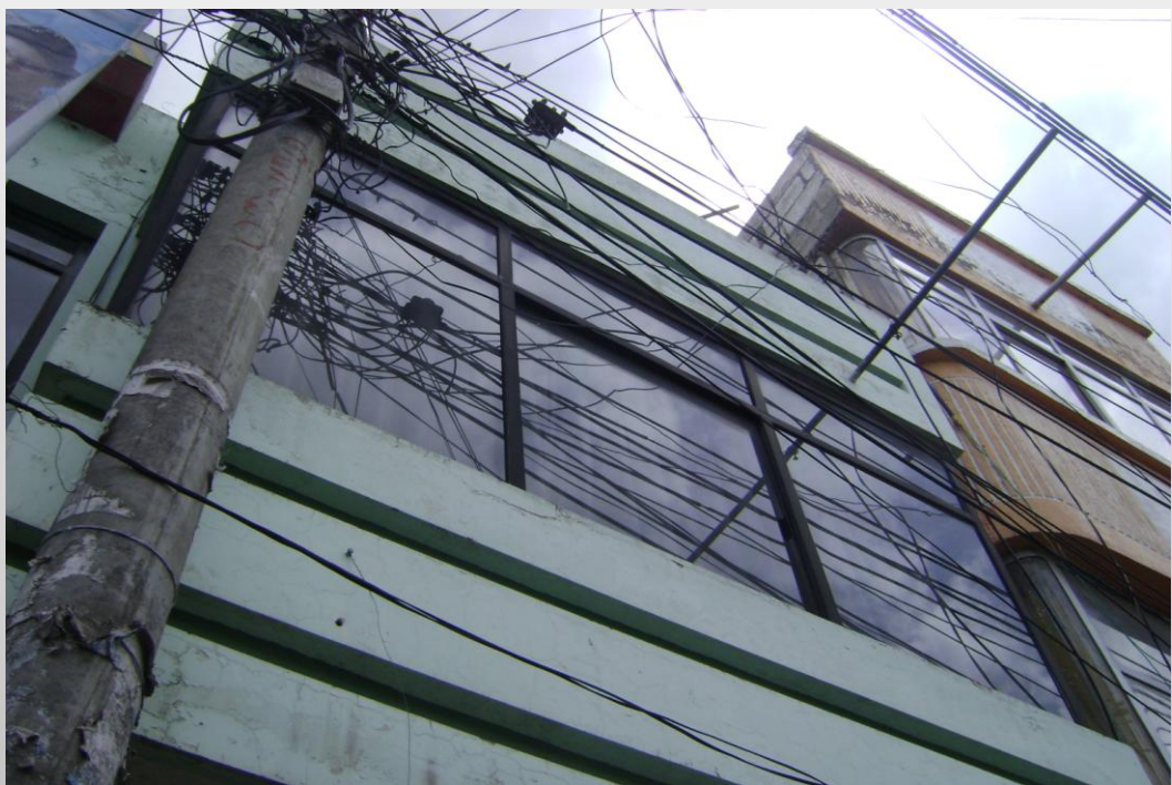
REDES AEREAS MAL UBICADAS
