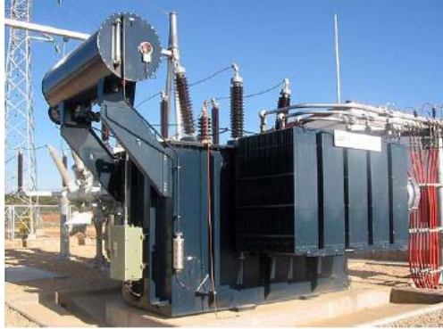
FIGURA 1.16. TRANSFORMADOR DE POTENCIA
