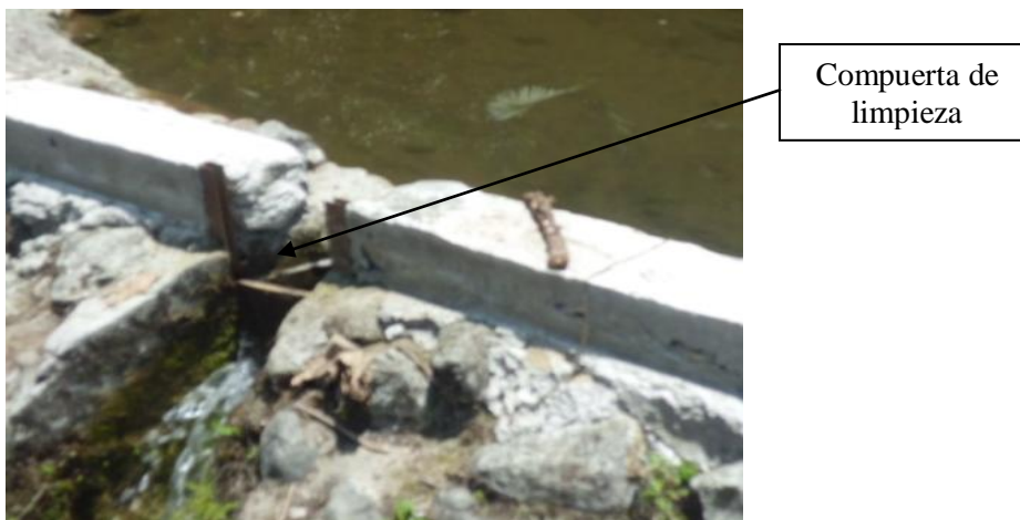
Figura 3.8. COMPUERTA DEL DESARENADOR
