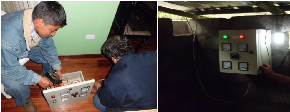
Figura 3.30. TABLERO DE CONTROL CON TODOS LOS INSTRUMENTOS ARMADOS.
