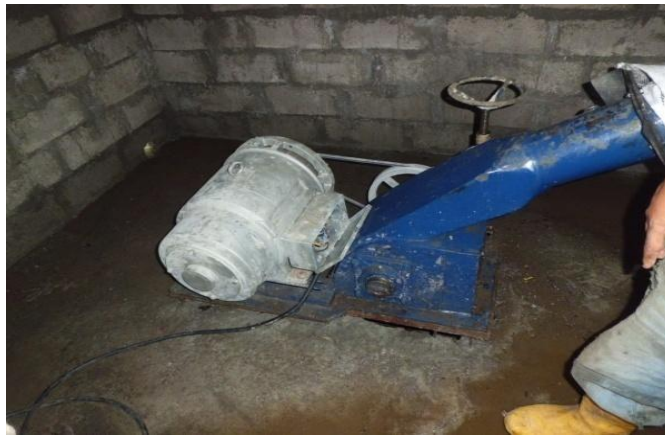
Figura 3.10. VISTA INTERIOR DE LA CASA DE MÁQUINAS
