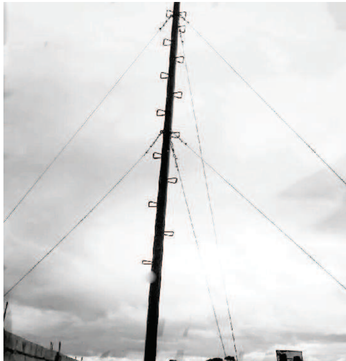
Figura 3.22. Torre emplazada en el lugar de ejecución del proyecto
