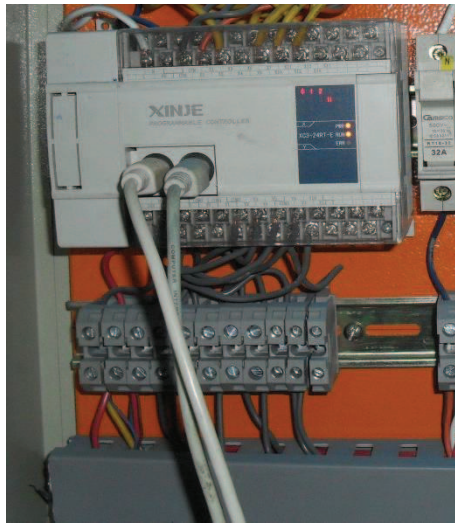
FIGURA 3.62 PUERTO DE COMUNICACIÓN PLC-OP
