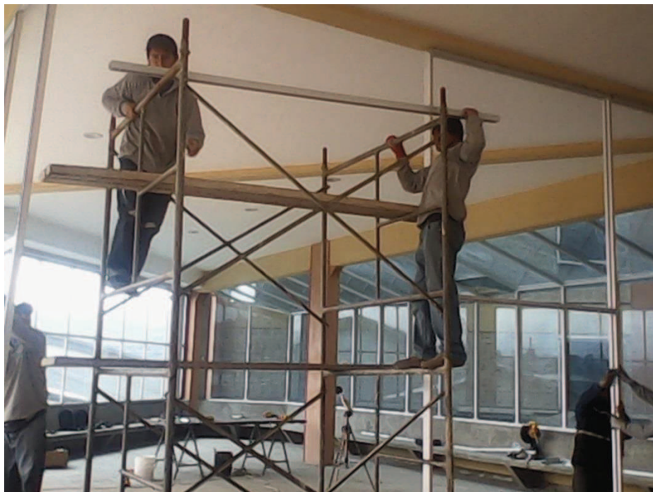
Ilustración 4: Trabajos en andamios sin protección
