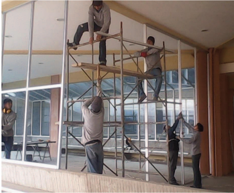
Ilustración 5: Trabajadores sin protección auditiva
