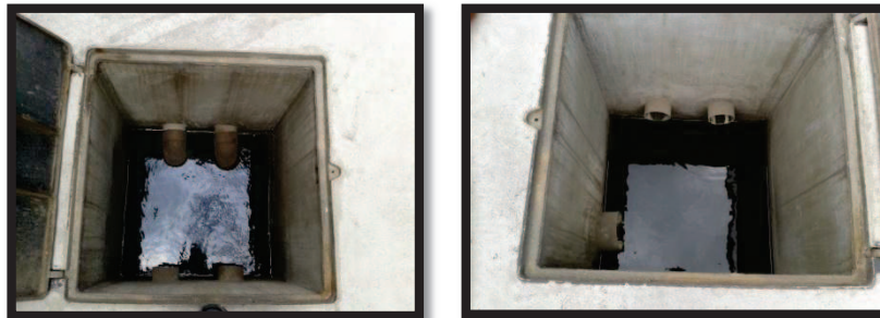
FOTOGRAFÍA No 34: TRAMPA DE GRASAS.
