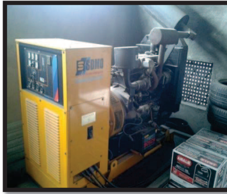
FOTOGRAFÍA No.38: DIQUE EN GENERADOR DE EMERGENCIA.
