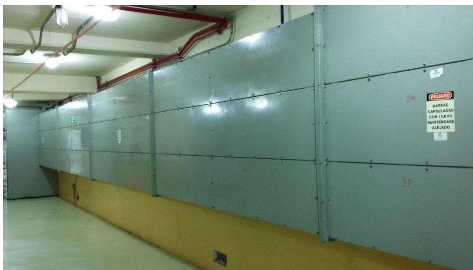
Fuente: Central Hidroeléctrica Pucara.
