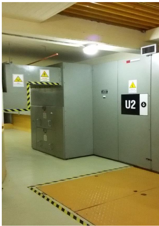
Fuente: Central Hidroeléctrica Pucara.
