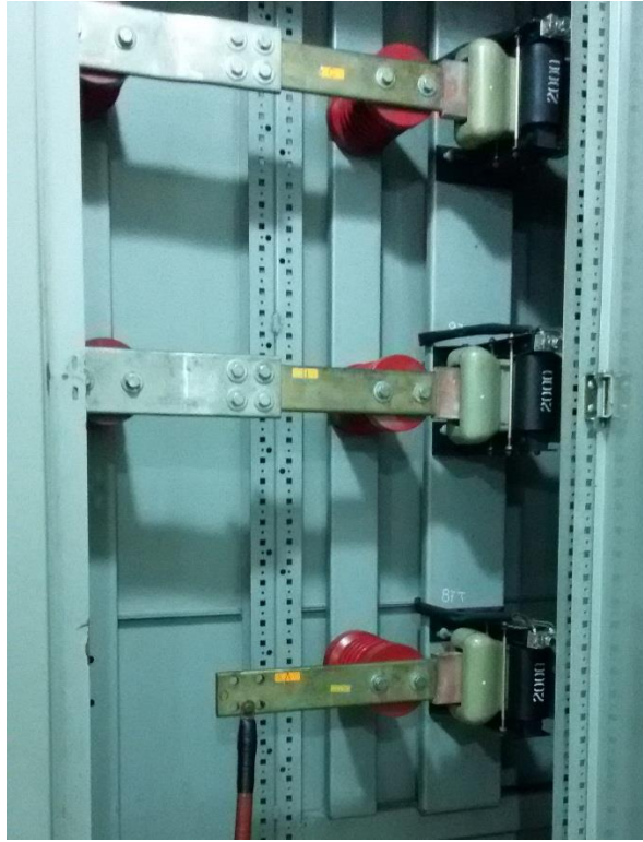
Fuente: Central Hidroeléctrica Pucara.
