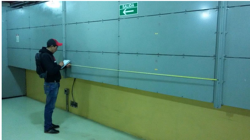
Fuente: Central Hidroeléctrica Pucara.
