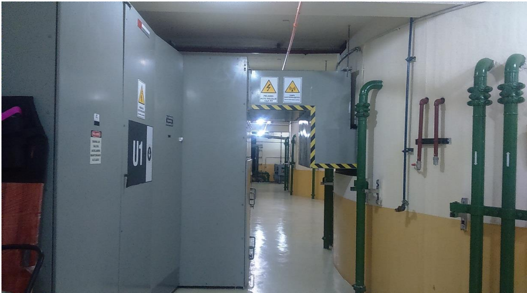
Fuente: Central Hidroeléctrica Pucara.
