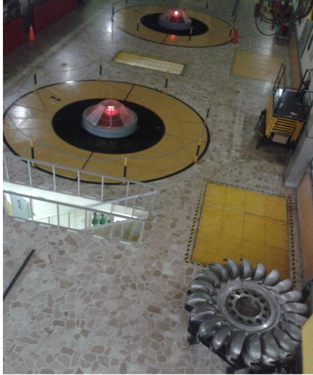
Fuente: Central Hidroeléctrica Pucara.
