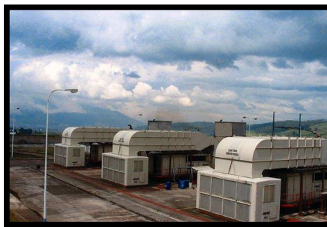
FIGURA 19. CENTRAL TERMOELÉCTRICA SANTA ROSA
