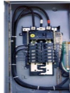
b.- .....electrical box
