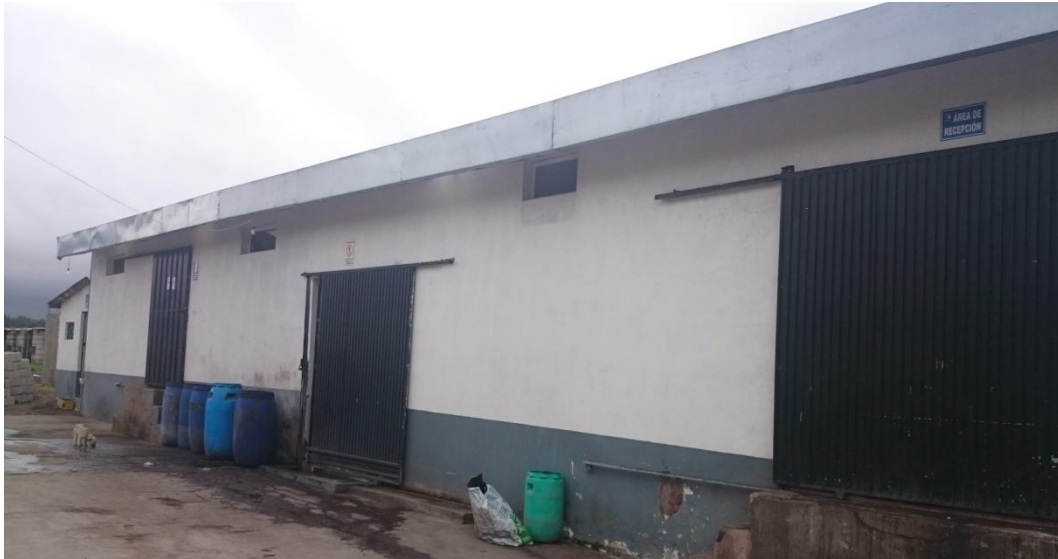
Fotografía 36. Techos y ventanas con protección en mal estado
