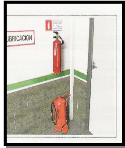
Gráfico N° 18: Extintores contra incendio
