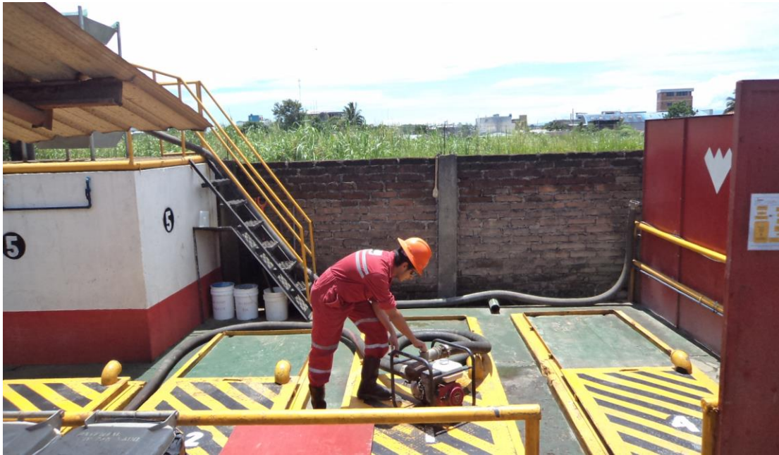
Bombeo de agua en planta de tratamiento
